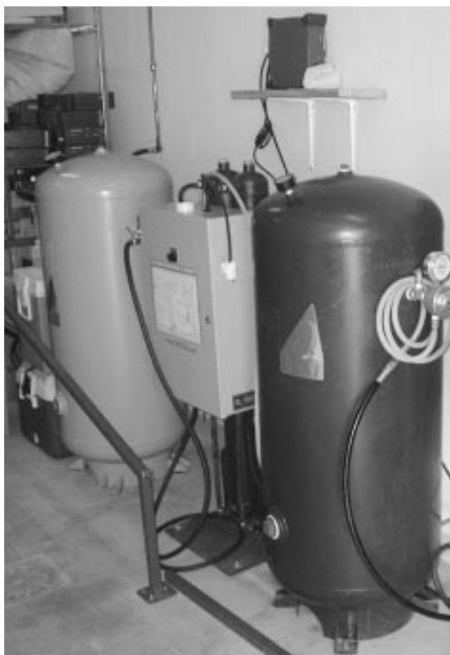
Figure 6 - Petite centrale de production d'O 2 à l'Hôpital de Koulamoutou (Gabon) avec de gauche à droite, le réservoir d'air comprimé, les deux colonnes PSA et le réservoir d'O 2 à basse pression. Matériel de OGSi. Cette centrale suffisante pour un hôpital provincial de 100 lits avec service d'urgence et bloc opératoire a coûté 16 000 euros et, par rapport à l'achat d'O 2 en bouteilles, a été amortie en moins d'un an.
