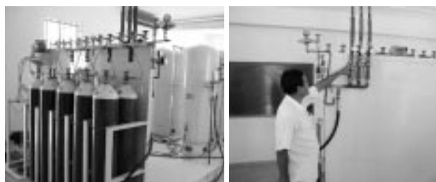
Figure 7 - Centrale de production d'O 2 PSA à fort débit, à l'Hôpital Calmette de Phnom Penh (Cambodge), permettant de remplir des bouteilles et d'alimenter le circuit de l'hôpital (blocs opératoires, réanimation). Matériel AirSep
